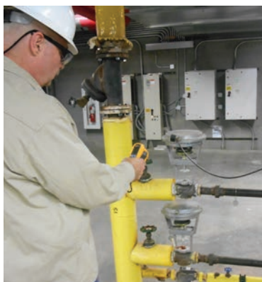
Dampf Temperatur am Eingang des Befeuchterventils messen
