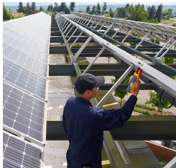
Die Fehlersuche ist ein wichtiger Bestandteil der Fähigkeiten eines professionellen Solartechnikers. Hier nimmt der Techniker an der Rückseite eines PV-Panels Messungen mit einer Fluke 393 FC vor.
