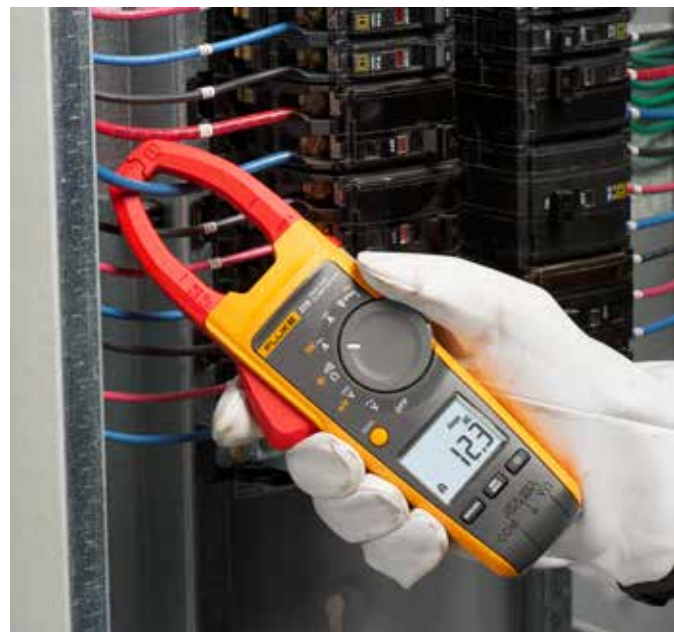
Messen des Stroms mit einer Strommesszange.
